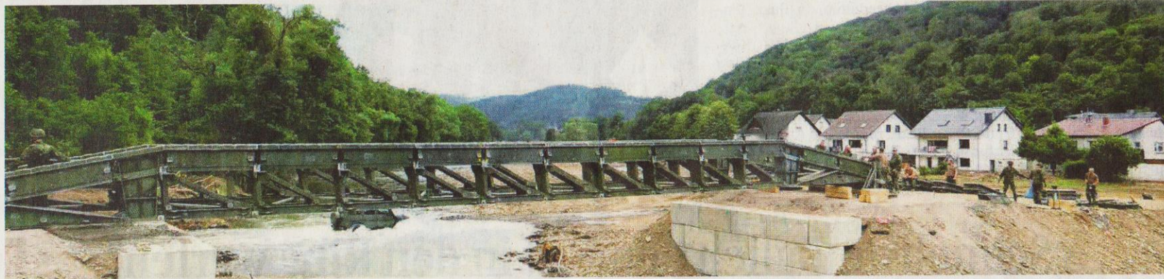
Die Festbrücke in Liers wird von den Panzerpionieren verlängert, damit sie dort dauerhaft im Einsatz bleiben kann.
